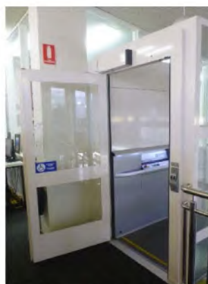
Door & door closer
