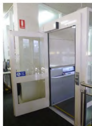
Door & door closer
